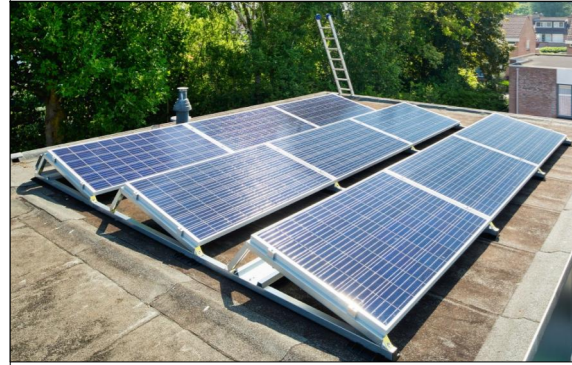
ZONNEPANELEN OP HET DAK
